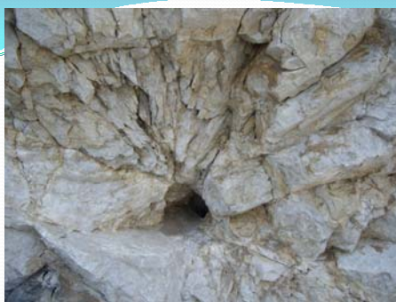
Ρωγμές σε θέση ανατίναξης εκρηκτικών
