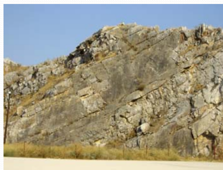
Επιφάνεια ρήγματος στο μέτωπο του πρανούς. Διακρίνονται επιφάνειες στρώσης και συστήματα διακλάσεων.
